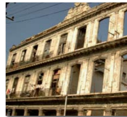
Nur die Fassade des einst prächtigen Gebäudes steht noch.
