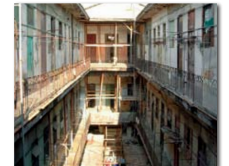
Der Teil des Gebäudes, der noch steht, wird als Wohnhaus genutzt. Der Zustand der Bausubstanz ist jedoch sehr schlecht.
